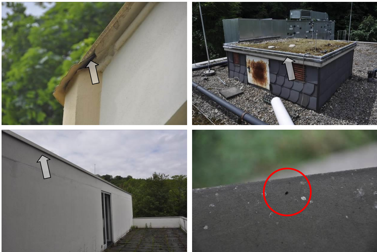
Abbildung 6: Spalten hinter Dachabkantung an den historischen und neueren Gebäudeteilen mit Eignung als Fledermausquartier (1. Zeile und 2. Zeile-links); Befund einer gelegentlich vorbeifliegenden kleinen Fledermausart (vmtl. Zwergfledermaus) durch Nachweis eines Kotkrümels auf einer Fensterbank des Trafogebäudes (2. Zeile-rechts)
